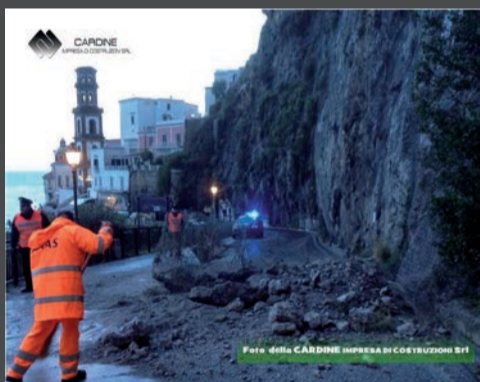
foto 1: Frana in roccia loc. Castiglione di Ravello
